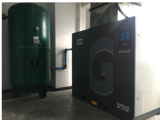
空压机升级更新运行情况
